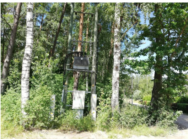
Fotofiksācija. 20/0,4 kV transformatora apakšstacija T-0646 (Meža ielas un Sila ielas krustojuma teritorijā)
